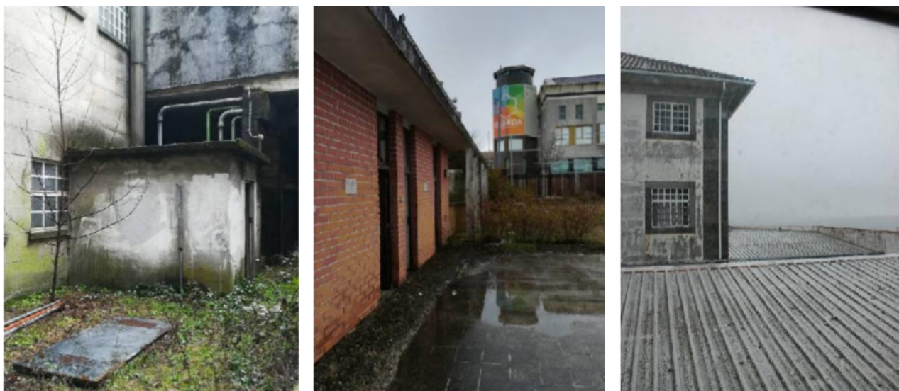
f|7 a f|9 - intervenções pouco consentâneas com o valor patrimonial em causa
