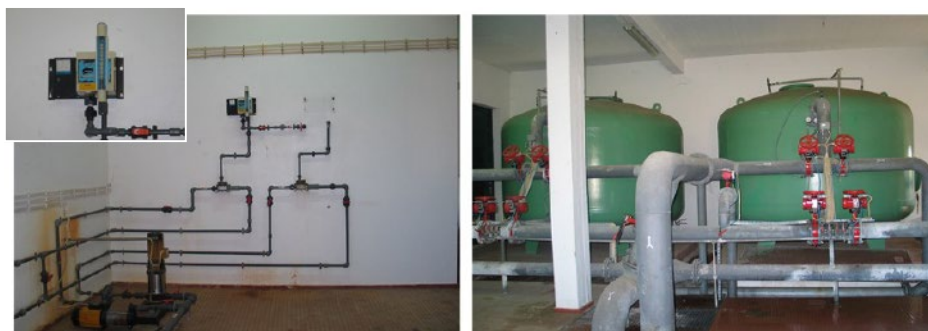
Figura 3. Sistema de higienização da água instalado e utilizado no campo de golfe dos Salgados entre 1996 e 2010 (cloração).
